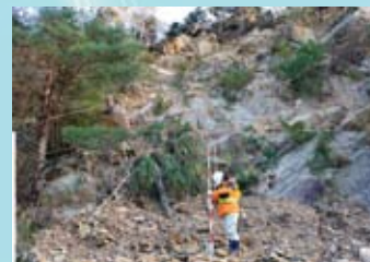
石巻市 (道路のり面災)
